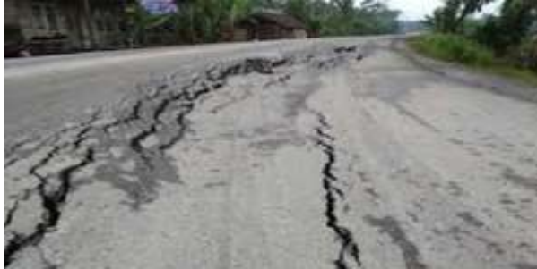
Gambar 5.4. Kerusakan jalan akibat kembang susut tanah dasar
