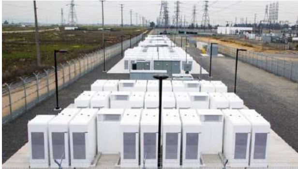
Gambar 2.10 Penyimpanan baterai listrik skala besar untuk solar farm dan excess production dari power plant [28]
